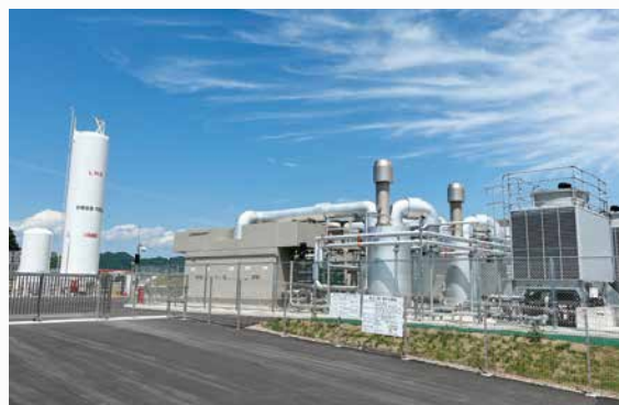
コージェネレーションシステム
