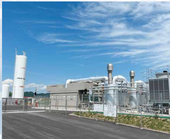
コージェネレーションシステム
